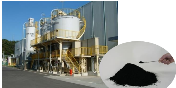
炭化燃料貯蔵設備
