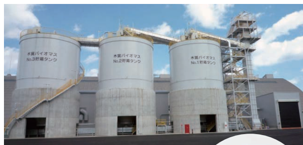
木質バイオマス燃料設備
