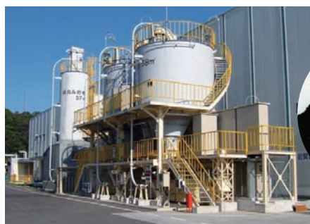
炭化燃料貯蔵設備
